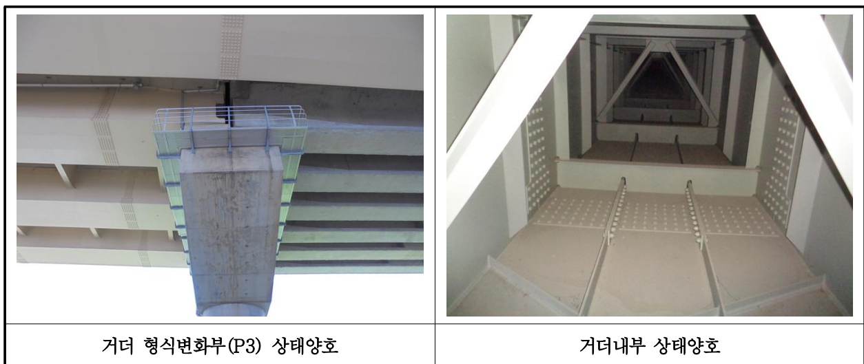
【사진 28.3.5】 거더 손상현황
